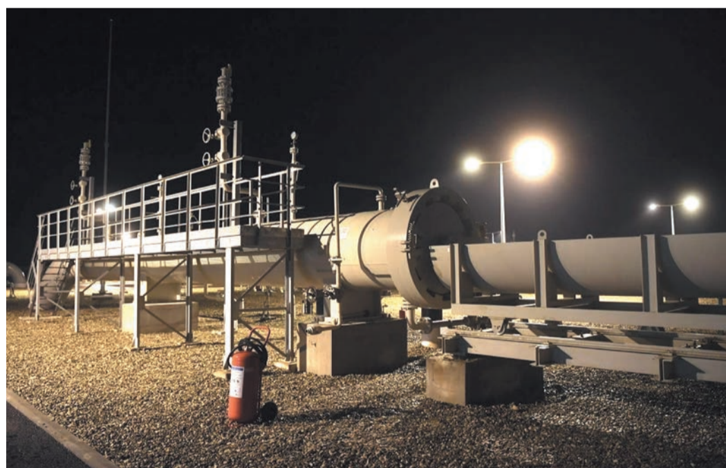
Газоизмерительная станция № 4, Господжинци, Сербия
